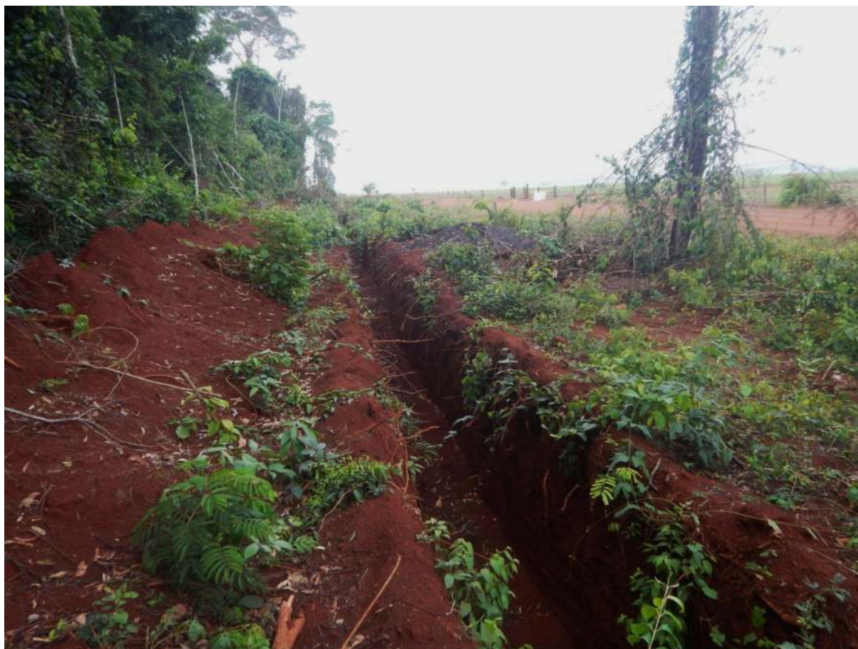
Figura 53. Vala com mais de 2m de profundidade a noroeste da TI Tanaru. Fonte: Amanda Villa [set/2023].
